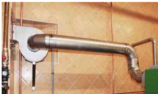
Ventilátor kéményfalra rögzítve
