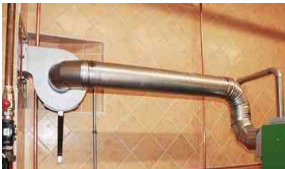
Ventilátor kéményfalra rögzítve
