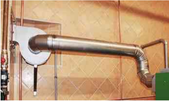
Ventilátor kéményfalra rögzítve
